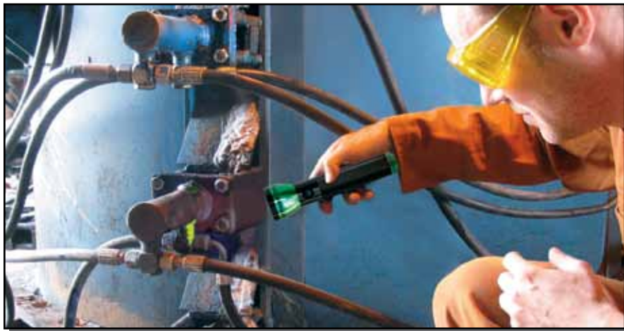
Detección de fugas en válvulas y conexiones usando la linterna de luz azul, de diodos – LED - OPTIMAX™ 3000
